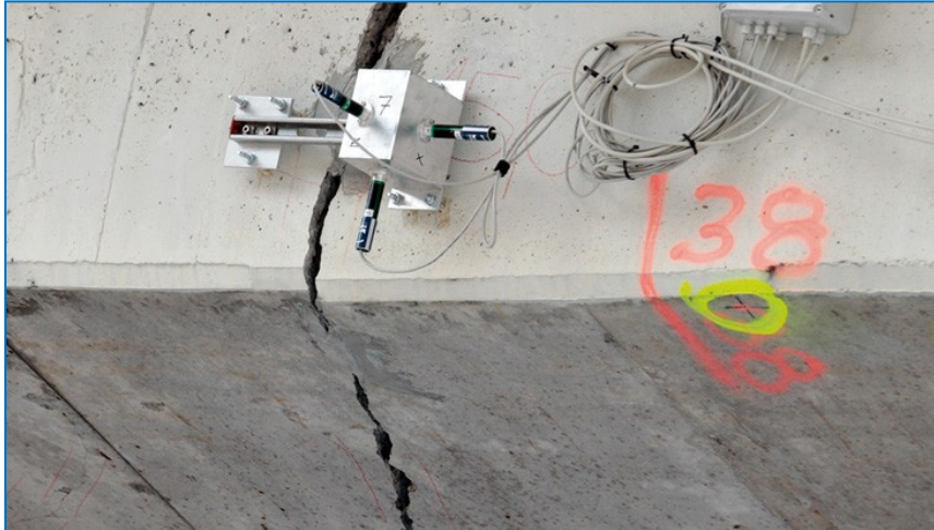
Torsionsbruch, Vorlandbrücke zur Rheinbrücke Schierstein, A643
